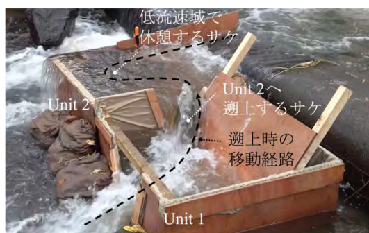
図3 現場に導入された提案魚道システム
